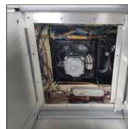
A5. Compartimento del condensador
