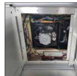
A5. Vano condensatore
